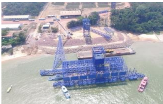
Figura 52 - Estação de transbordo e carregamento de barcaças - HBSA
